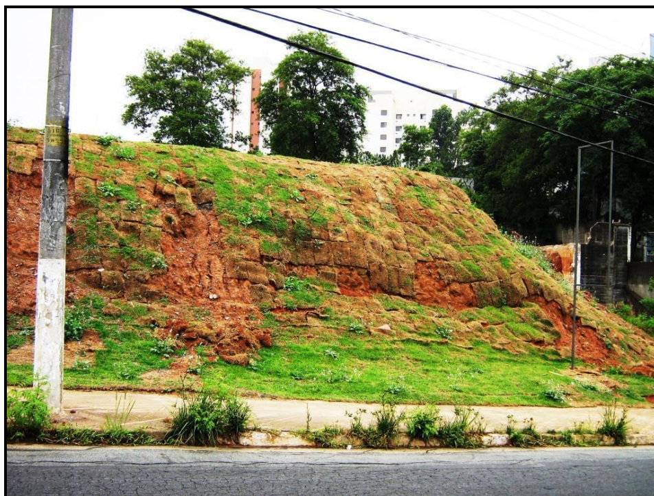
A grama em placa é uma ótima solução para proteção superficial, mas é uma proteção hoje relativamente cara, o que sugere mais cuidado em sua aplicação. Por exemplo, não vinga em taludes de declividade alta e não resolve absolutamente nada em caso de fenômenos de rupturas rasas ou profundas, como mostra a foto. (Foto do Autor)
