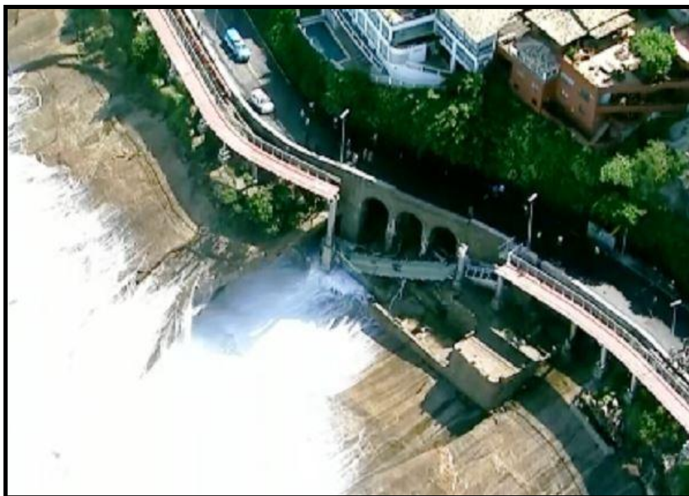
Destruição de trecho do tabuleiro da Ciclovia Tim Maia
