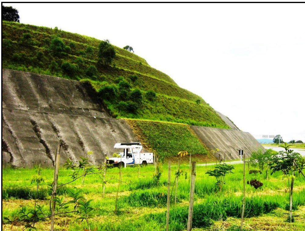
Tela argamassada substituindo proteção vegetal. Incompetência técnica ou descompromisso profissional? (Foto do Autor)
