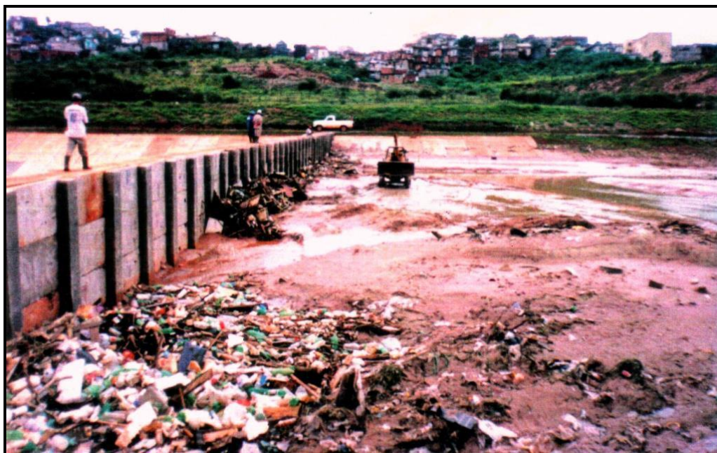
Interior de um piscinão: assoreamento de sedimentos e lixo difícil de se remover, além da alta contaminação pela poluição das águas superficiais da metrópole. (Foto do Autor)
