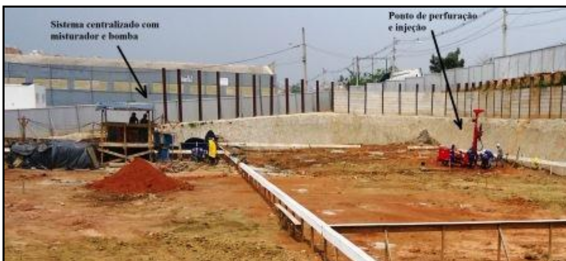
Sistema centralizado com misturador e bomba atendendo vários pontos de injeção. Foto ARSantos.
